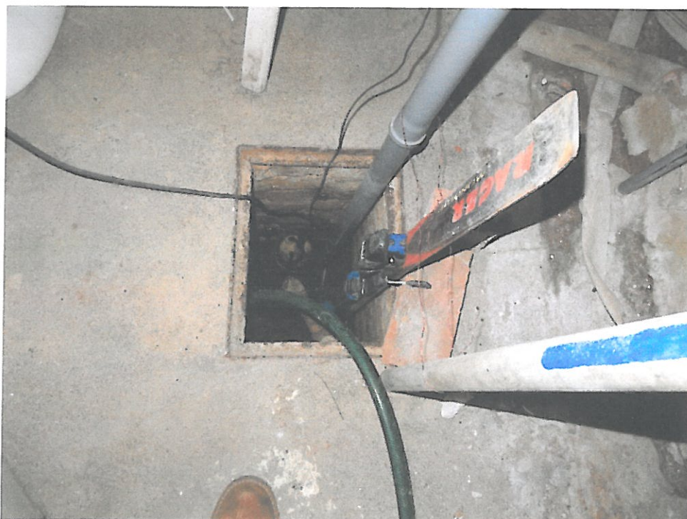
Zdjęcie nr 18 – Widoczna studzienka nr 2 i pompa w części wysokiej budynku
