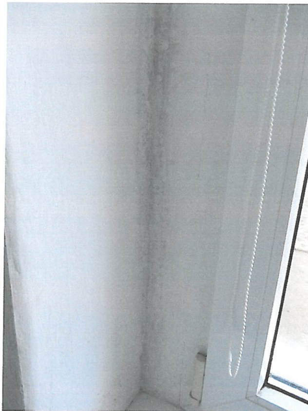
Zdjęcie nr 3 – Widoczne wykwity na ościeżu okna
