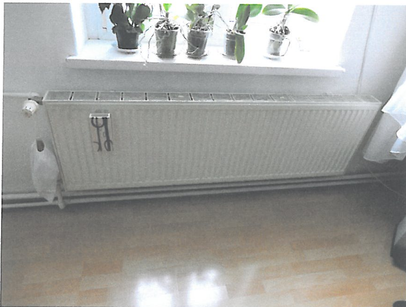
Zdjęcie nr 5 – Widoczny wiszący na kaloryferze zbiorniczek na wodę
