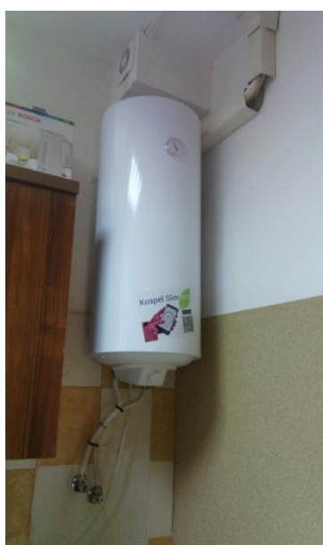
Fot. 11. Bojler (w sąsiednim pomieszczeniu)
